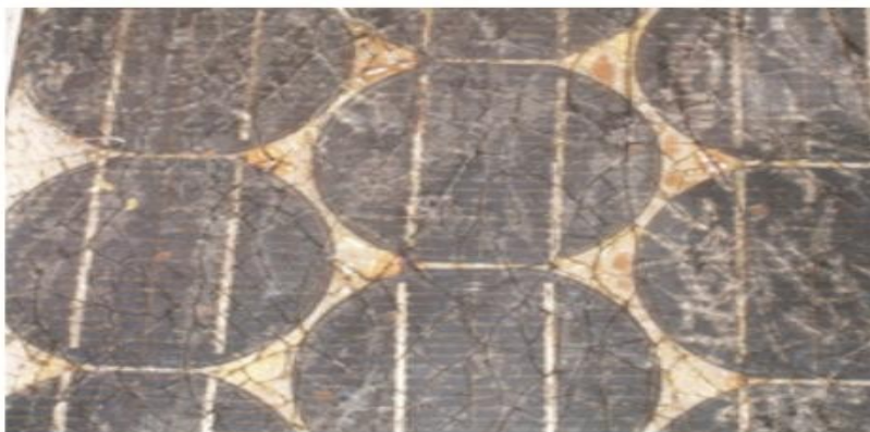
Gambar 7.6: akibat dari air dan karat pada panel surya
