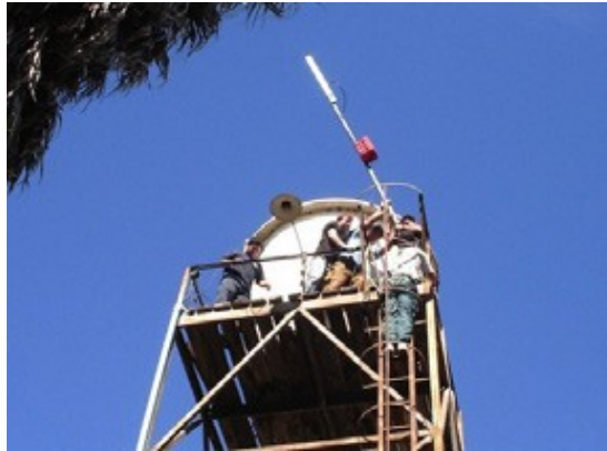
Gambar 11.24: Pemasangan node di atas menara air di Batuco, Wilayah Metropolitan, memberikan backhaul untuk telecenter Cabrati.
