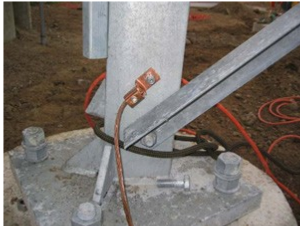
Gambar 5.2: menara dengan sebuah kawat tembaga besar yang menghubungkan ke tanah
